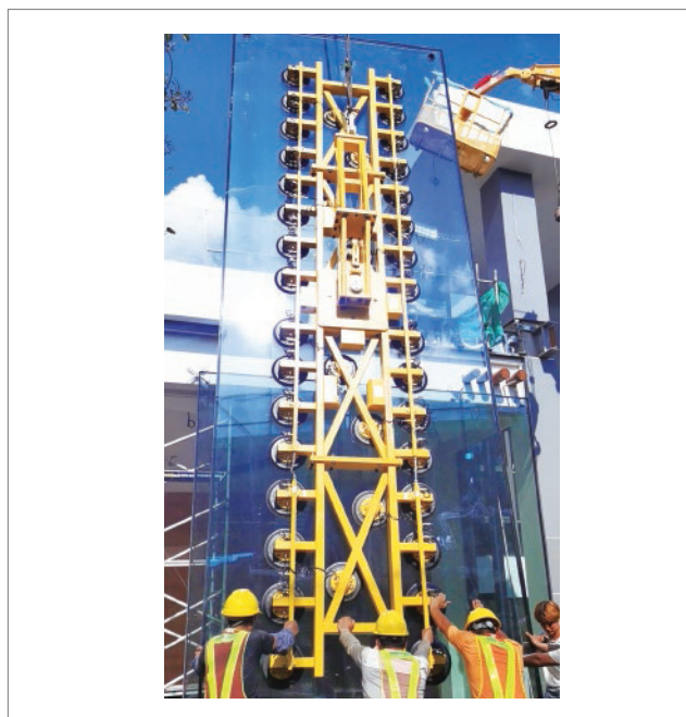
室外大型玻璃幕墙安装(双系统) 直流四十爪吸吊设备 HP-GH4000-40S (4000KG)
